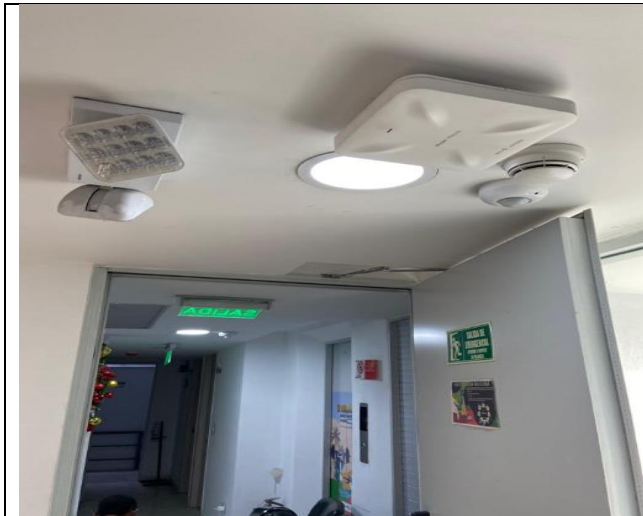
EQUIPO WIFI RUIJIE RG-RAP2260H
