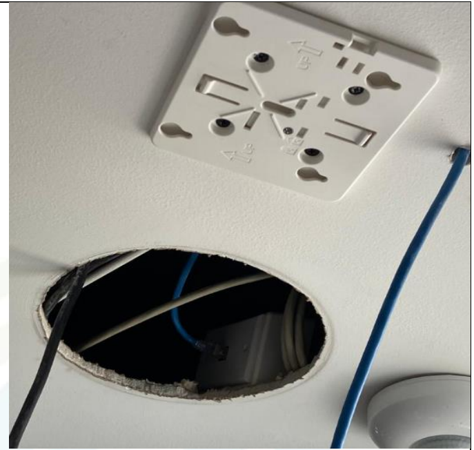
DETALLE CAJA DE CONEXIONES
