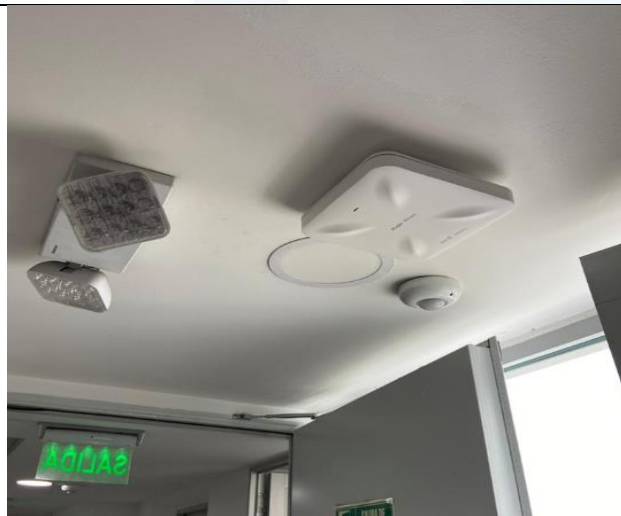
EQUIPO WIFI RUIJIE RG-RAP2260H
